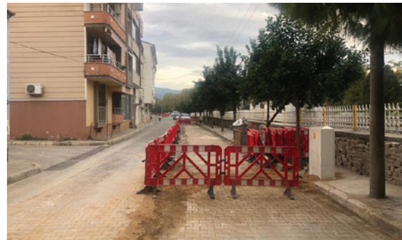
Selçuk İlçesi (GDZ Elektrik Dağıtım A.Ş.'nin Enerji Hattı İşini)
