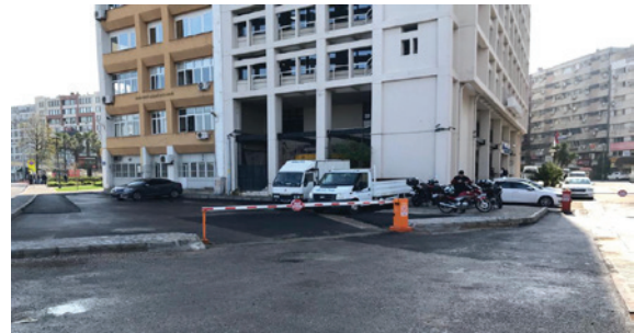
Kemeraltı 1. Etap, Yağmursuyu Terfi Merkezi ve Atıksu ve Yağmursuyu Hatları (Kuşaklama Hattı)
