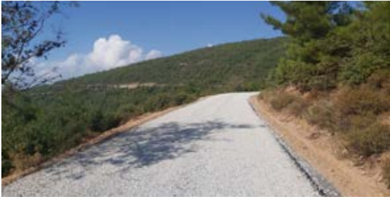
Bayındır Çamlıbel Mahallesi Sathi Kaplama
