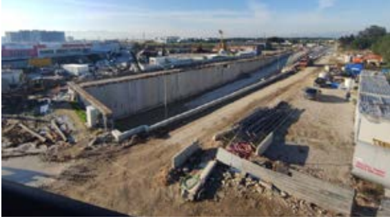
Çiğli 2. Ana Jet Üssü Karayolu Alt Geçidi Güçlendirmesi
