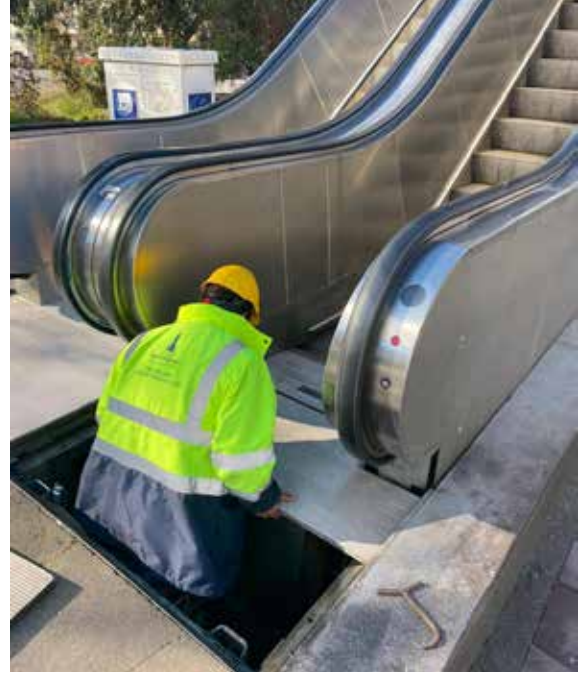
Yürüyen Merdiven ve Asansörlere Ait Bakım ve Onarım
