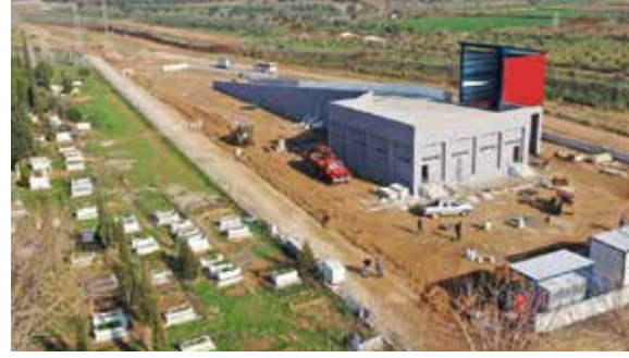
Ödemiş Katı Atık Transfer İstasyonu
